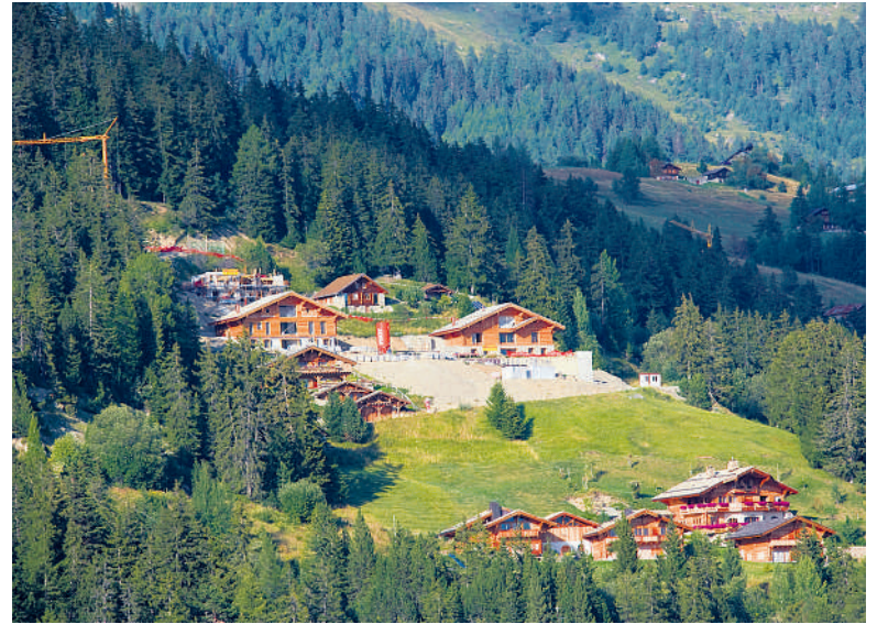
On fait de larges tranchées, plaies béantes dans la fragile forêt de montagne, pour une agglomération de résidences secondaires à Aminona (VS)
